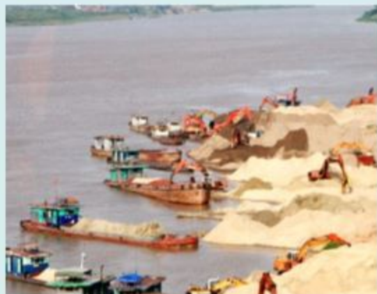
Việc khai thác cát trái phép đã ảnh hưởng đến an toàn hệ thống đê điều
